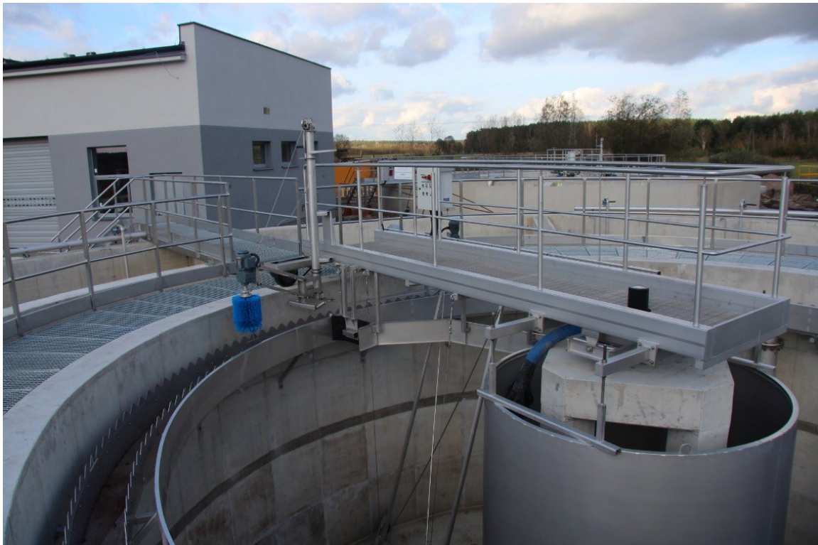
Oczyszczalnia ścieków w Osiecznej
