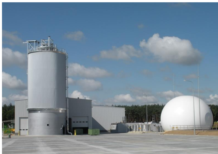
Rys. 8. Zakład Zagospodarowania Odpadów w Trzebani - komora fermentacyjna
