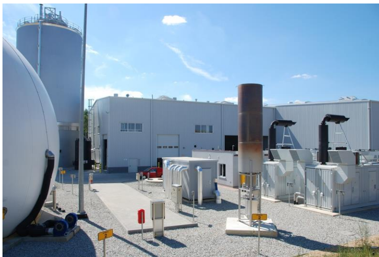
Rys. 9. Zakład Zagospodarowania Odpadów w Trzebani- hala technologiczna
