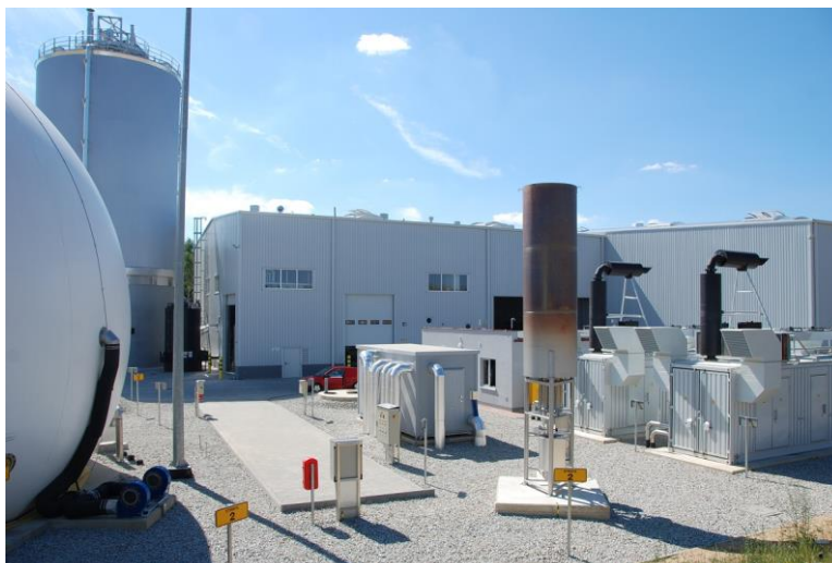
Rys. 9. Zakład Zagospodarowania Odpadów w Trzebani- hala technologiczna
